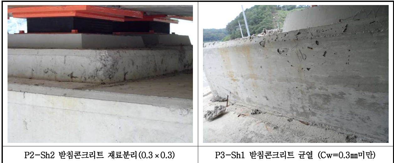
【사진 39.3.13】 교량받침 손상현황
